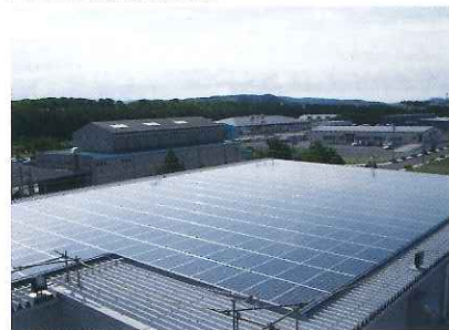
203.3kWシステム
